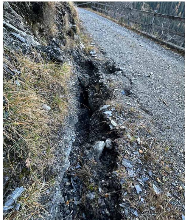
Erschliessung Varduz in Duvin, Val da Sum Punt: Deutlich sichtbare Ablösung der Felspartie am Strassenkörper.
