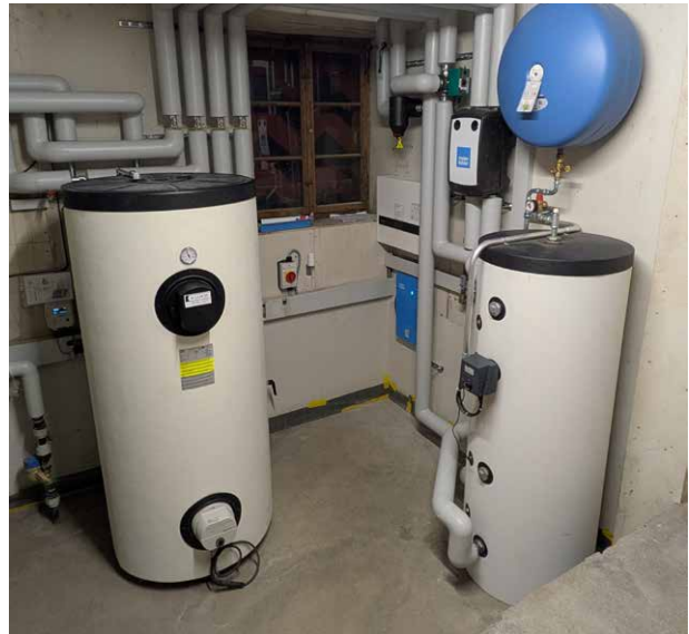
Heizung des Gebäudes im Gebiet Fontanivas in Ilanz.
