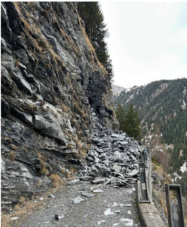
Erschliessung Varduz in Duvin, Val da Sum Punt: Die bergseitige, instabile Felschuppe ist kollabiert und ein Teil der Ablösung hat sich auf der Strasse abgelagert.
