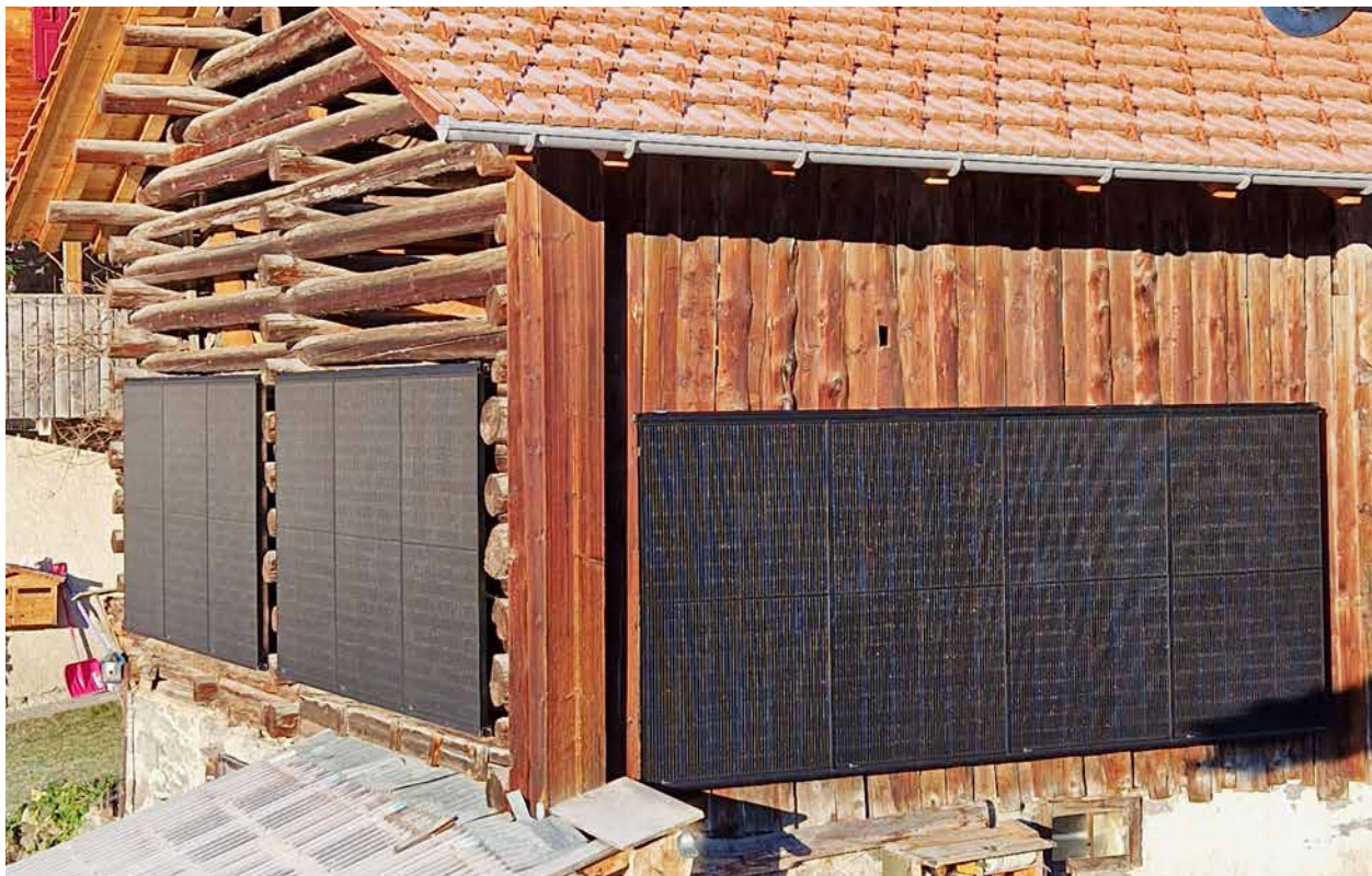
Photovoltaikanlage (PV-Anlage) an einer Fassade.
