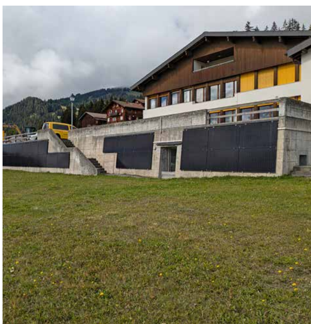
27 Die PV-Anlage an der Stützmauer der Casa Sentupada in Siat.
