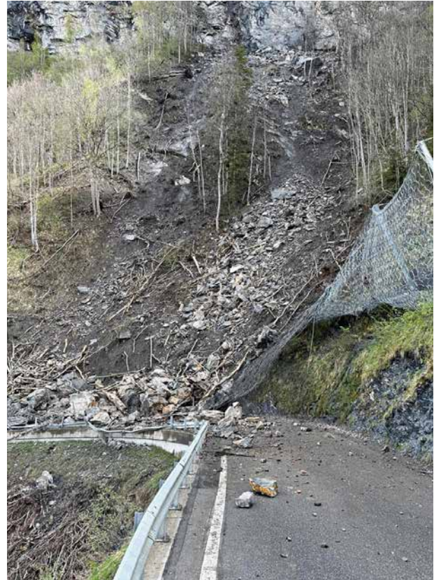
Verschüttete Kantonsstrasse nach Riein: Die vorhandene Steinschlagschutzzei- richtung war für dieses Ereignis deutlich unterdimensioniert.
