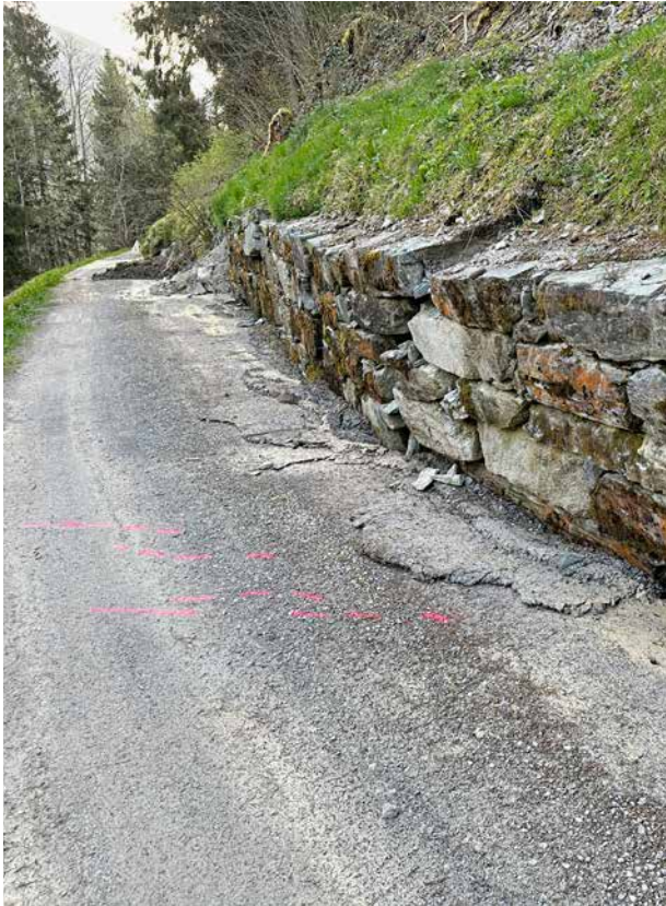
Die Stützmauer beim Polenweg kann die enorme Last der Gesteinsmasse nicht mehr aufnehmen und kippt.
